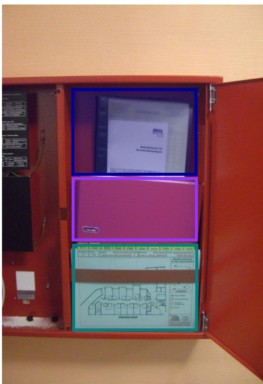
Betriebsbuch für Brandmeldeanlagen Feuerwehrpläne Feuerwehr-Laufkarten
